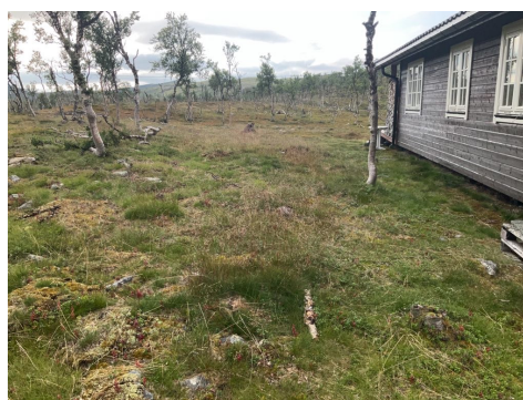
terreng mot øst noe fall inn mot hytten men det er fundamenter av impregnerte trestolper som tåler fukt.
