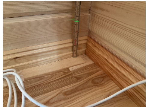
påvist noe høydeforskjell på golv stue
