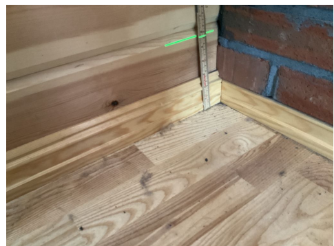
påvist noe høydeforskjell på golv stue
