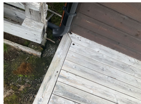
vann fra nedløp må føres bort fra bygningen / fundamentering
