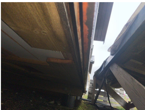
ikke påvist musebånd, men bygget tilnærmet helt tett.
