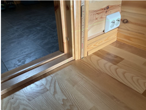
påvist noe høydeforskjell på golv stue
