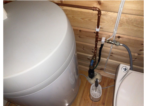
stoppekran på bad
