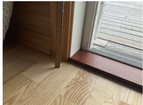
påvist noe høydeforskjell på golv stue
