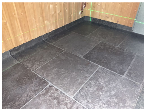
overgang vegg/golv i badstue
