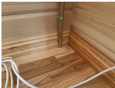
påvist noe høydeforskjell på golv stue
