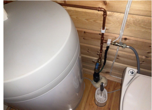
stoppekran på bad
