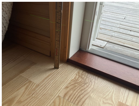
påvist noe høydeforskjell på golv stue
