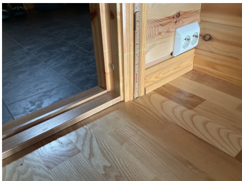
påvist noe høydeforskjell på golv stue
