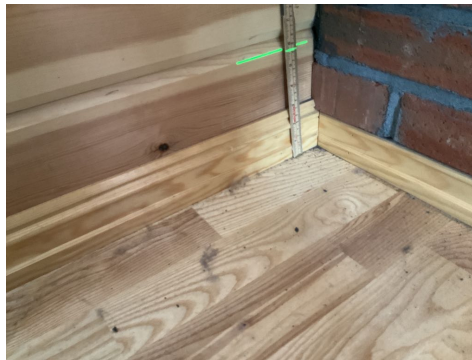
påvist noe høydeforskjell på golv stue
