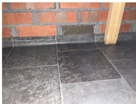
overgang vegg/golv i badstue
