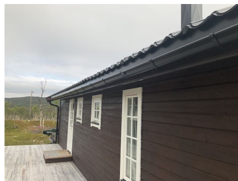
takrenner nedløp og beslag
