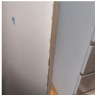
Innerdører - Skade i baderomsdør
