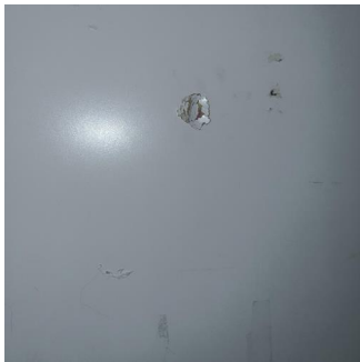
Innerdører - Skade i soveromsdør
