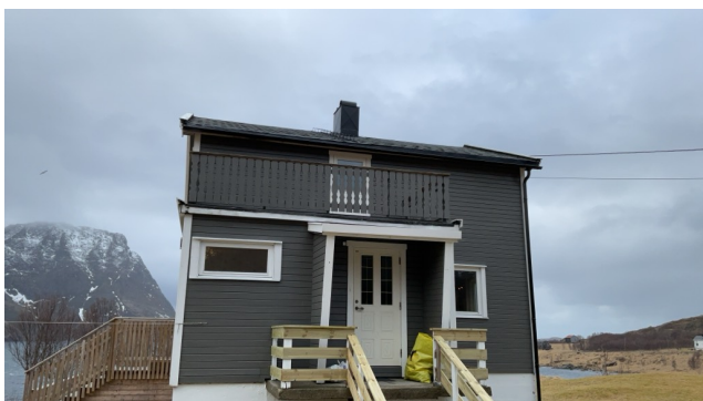
Eksempel på manglende takrenne.
