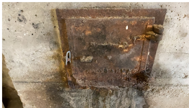
Eksempel på skader på sotluke.
