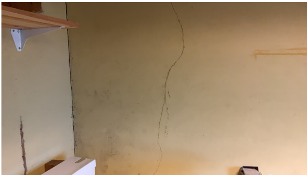
Eksempel på sprekke.
