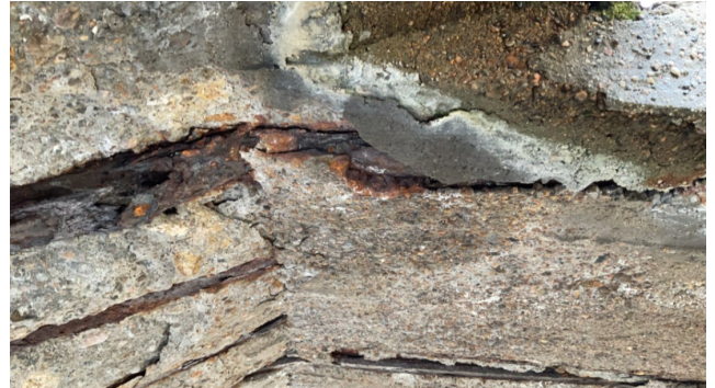
Eksempel på delaminering i betong og rustskadet armering.
