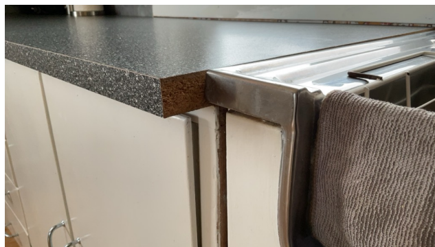
Eksempel på manglende kantlist.
