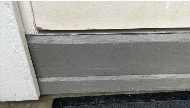
Eksempel på manglende beslagsutførelse under dør.
