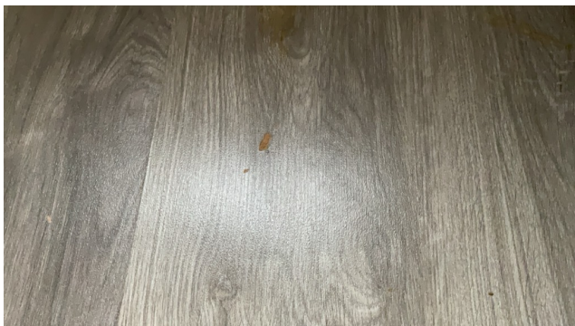
Eksempel på skade.
