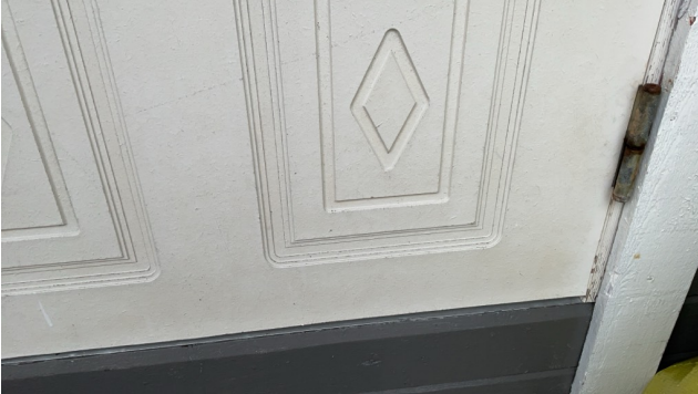
Symptom på fuktsvelling.
