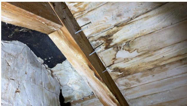
Eksempel på eldre fuktskjolder.
