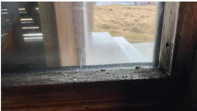
Eksempel på råteskadet vindu.
