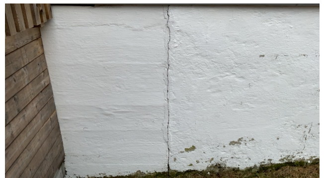
Eksempel på sprekk.
