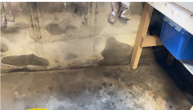
Eksempel på fuktinntrengning.
