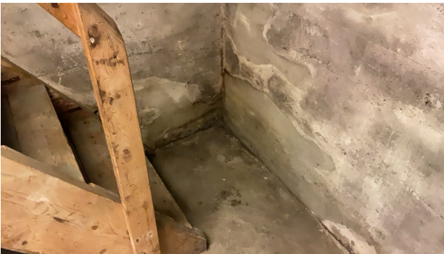
Eksempel på fuktinntrengning.
