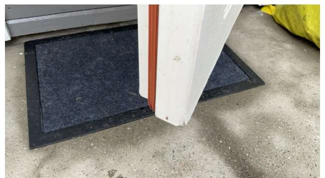
Eksempel på skade på hovedinngangsdør.
