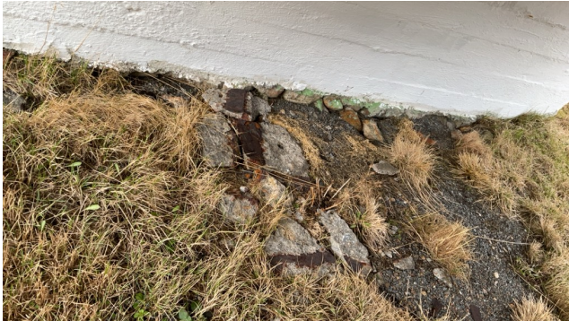
Eksempel på symptom på sig i masser under murt ringmur.
