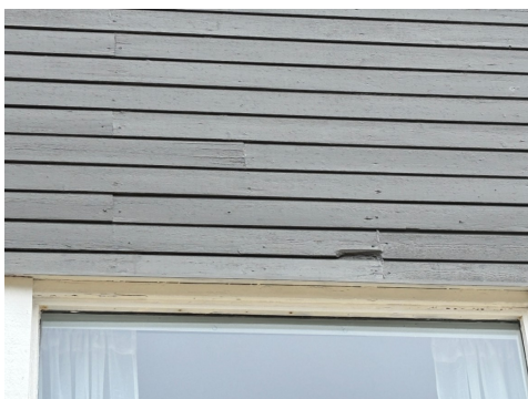
Eksempel på stedvis råteskade på bordkledning.
