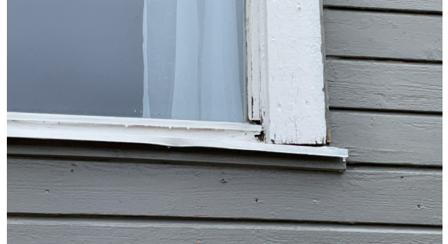
Eksempel på råteskadet vindu.
