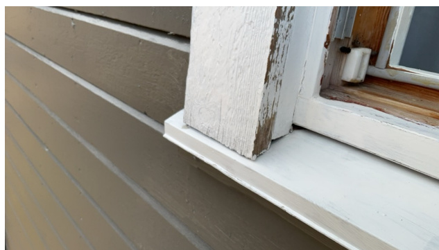
Eksempel på manglende åpning mellom beslag og kledning.
