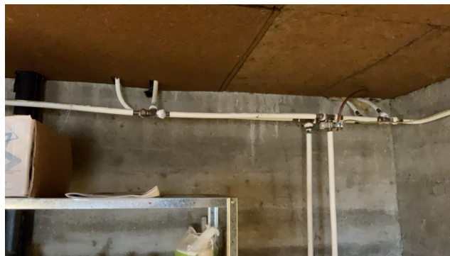
Eksempel på manglende klamring.
