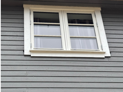
Eksempel på ufagmessig utførelse av utvendig omrammingsbord på vindu.
