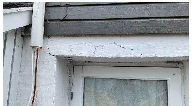
Eksempel på sprekker.
