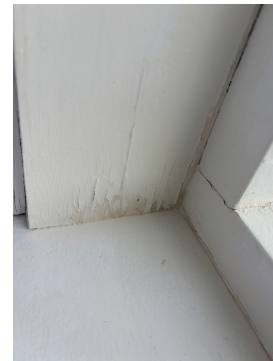
Eksempel på symptom på svikt i utvendig tetting,
