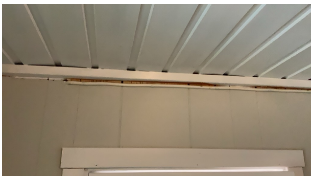
Eksempel på skade i overflaten etter tidligere installasjon.
