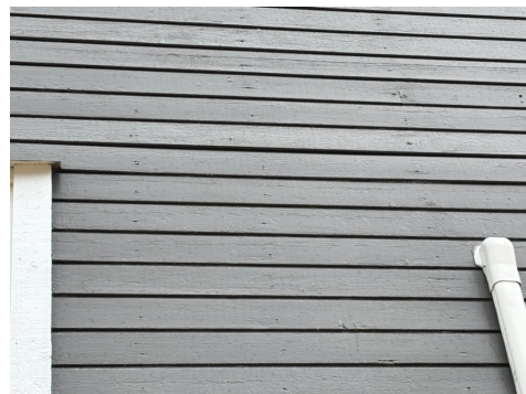
Eksempel på oppsprukket/værslitt bordkledning.
