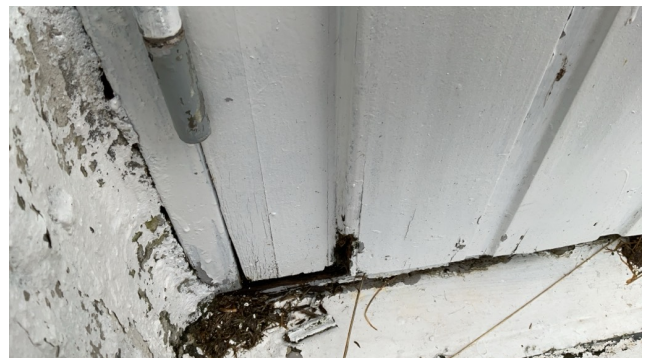
Eksempel på råteskade.
