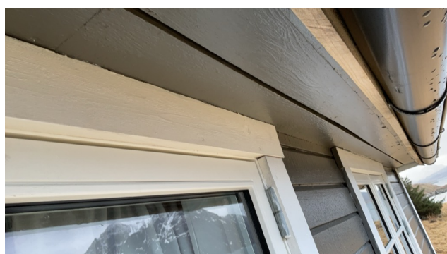
Eksempel på manglende beslagsløsning over vindu.
