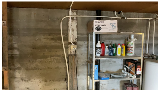
Eksempel på manglende klamring og irr.
