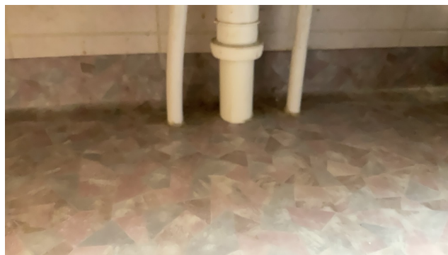
Eksempel på manglende våtromsutførelse ved rørføring i våtsone.
