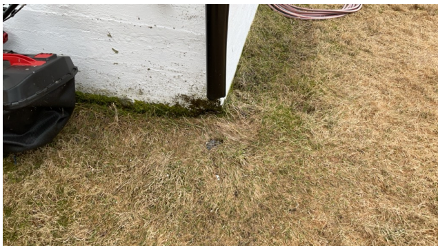
Eksempel på manglende bortledning av vann fra taknedløp.
