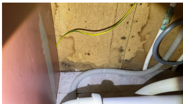
Eksempel på fuktskjolder.
