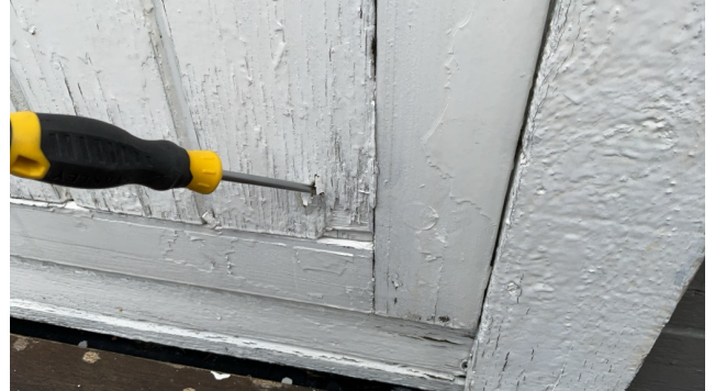
Eksempel på råteskade.
