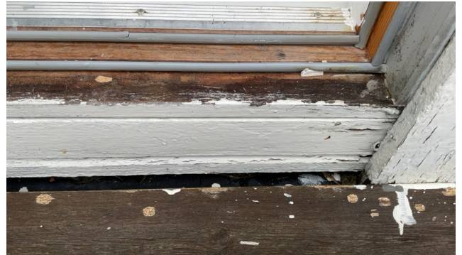
Eksempel på manglende beslagsutførelse under dør.
