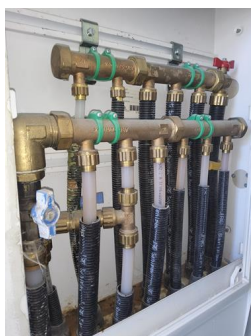
Fordelerskap og fordelerstammer - Fordelerskap
