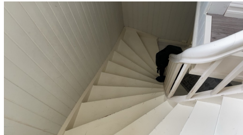
Det mangler håndløper på vegg i trappeløpet.
