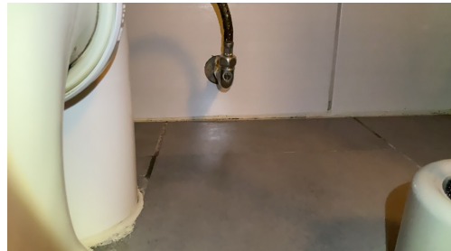
Utilfredstillende tetting ved rørgjennomganger
