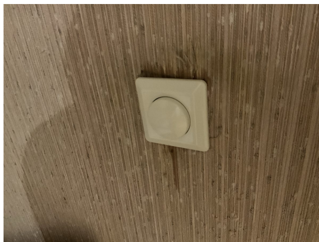
Foto 13: Slitasje og kondensmerker rundt lysbryter 3.etg
