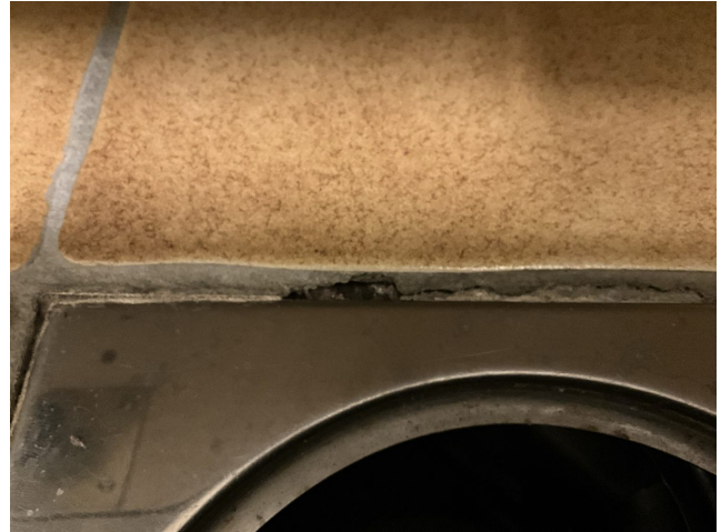
Foto 5: Sprukken og løs fuge mot sluk. Ingen synlig membran.
