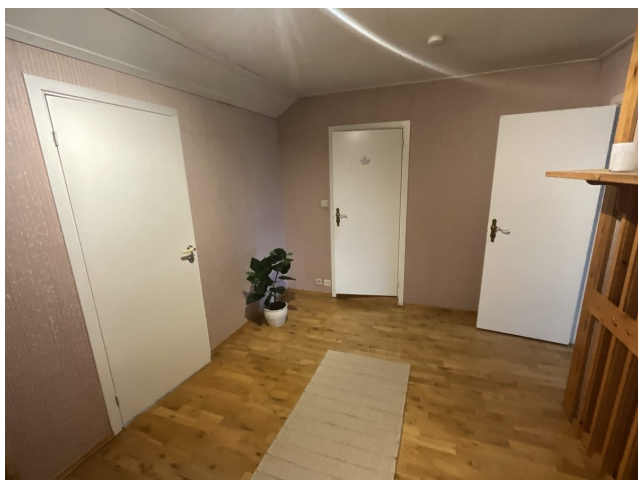
Foto 12: Innvendig overflater 3.etg
