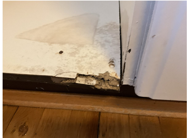
Foto 8: Skade i underskapsskrog
