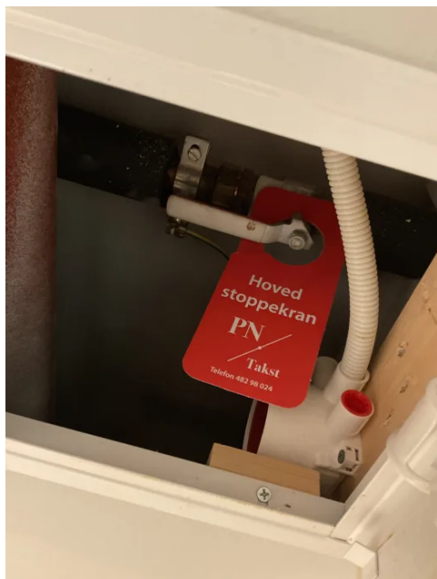
Hovedstoppekran med synlig merking
