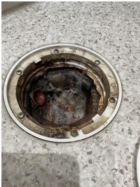
Gulvbelegg synlig ført under klemring
