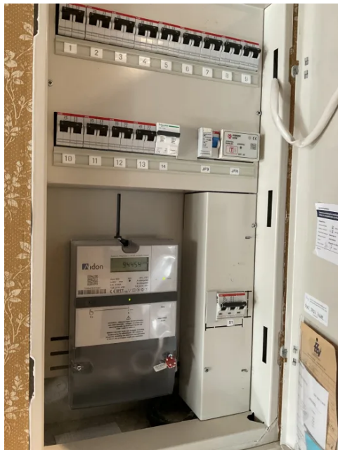
Sikringsskap plassert i gang
