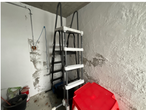
Malingsavflassing og kalkutslag i utvendig kjellernedgang.
