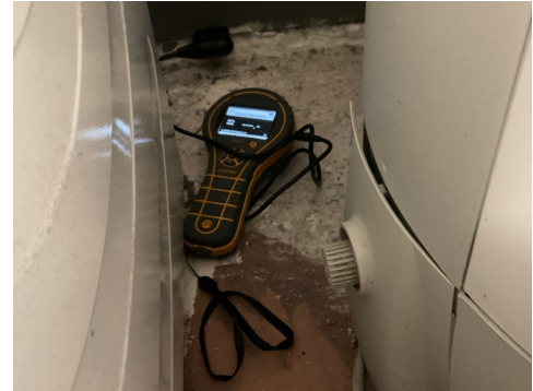
Måling i vegg bak vaskemaskin 28.01.2026
