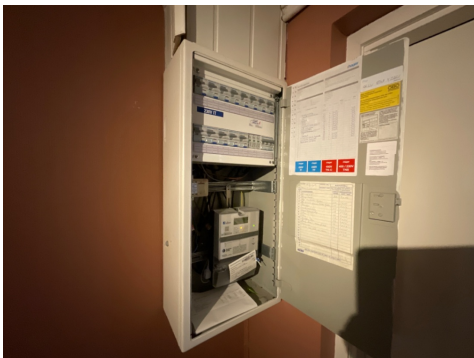
Sikringskapp i kjellergang
