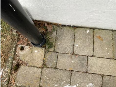
Nedløp til plastrør ved grunnmur og synlig knotteplast.
