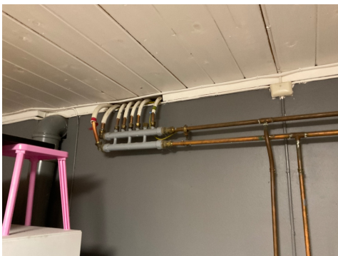
Vannledninger i vaskerom
