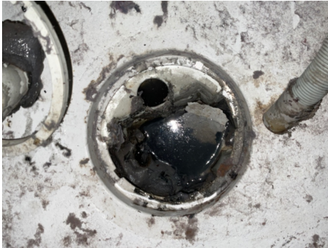
Sluk på vaskerom
