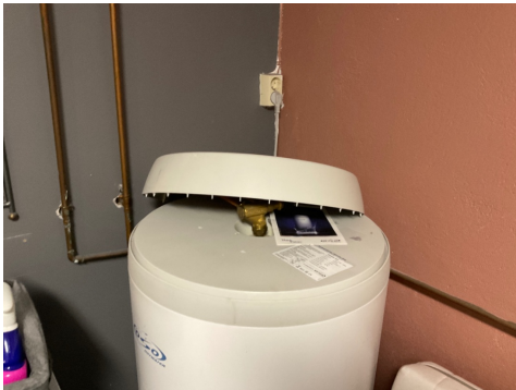
Varmtvannstan i vaskerom
