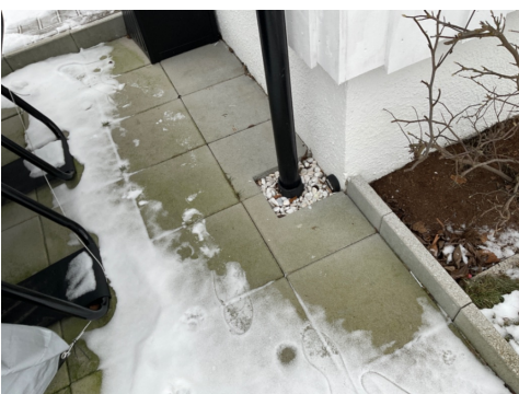
Nedløp til plastrør i grunnen
