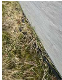
Grunnmursplast løsna fra kantlist
