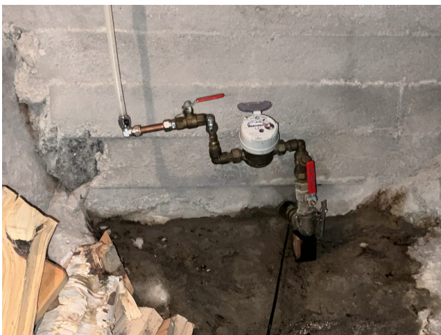
Foto 29: Stoppekran og vannledning fra kommunalt nett
