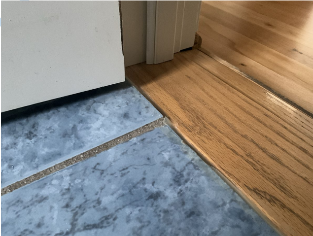
Foto 17: Fliser mot dørterskel
