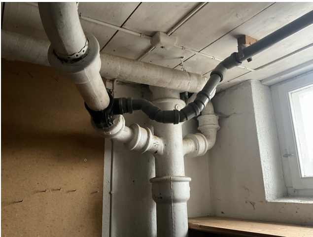
Foto 33: Elde og nyere avløpsrør i kjeller
