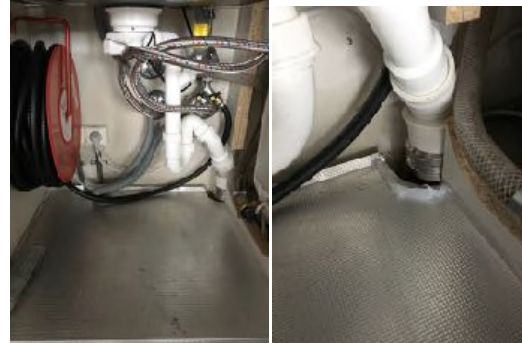
Brannslangen med tilkoplingskran.
