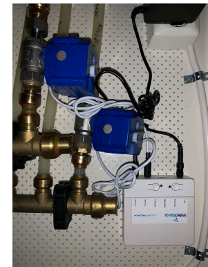
Dette er det som er installert i skapet med stoppekraner i gangen i leiligheten.
