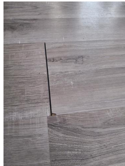
Overflate gulv - Glippe og skade i stuegulv
