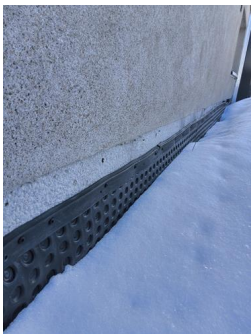
Fuktsikring av grunnmur - Sig i utvendig fuktsperre
