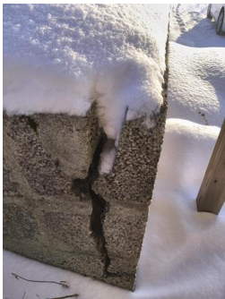
Tilstand - Sprekker i forstøtningsmur
