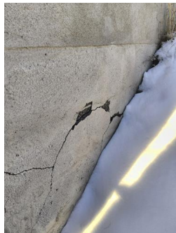
Grunnmur og fundament - Sprekker i grunnmur
