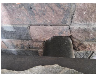
Skorsteiner inne i boligen - Sprekker i teglstein
