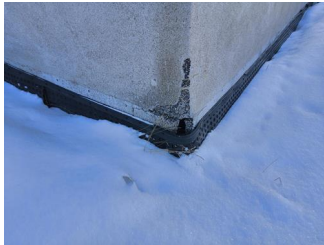
Grunnmur og fundament - Skade i grunnmur
