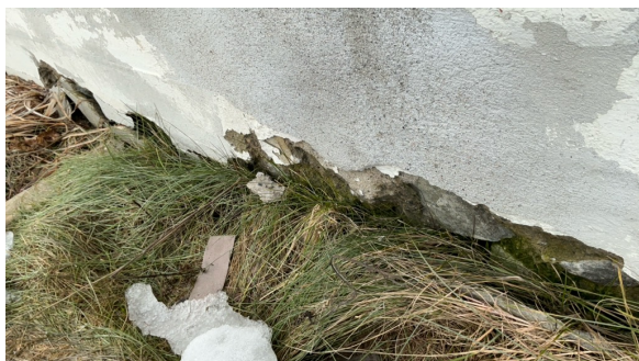
Avskalling og forvitring av grunnmur indikerer dårlig betongkvalitet.
