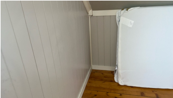
Enkelte synlige skjevheter sett innenfra.
