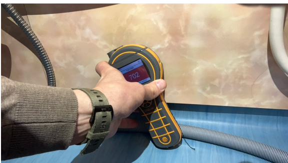
Fuktsøk på badersomspanel viste forhøyde verdier.
