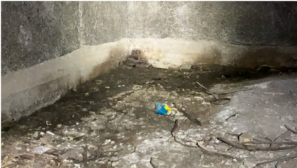
Synlig fukt på deler av grunn i krypkjeller.
