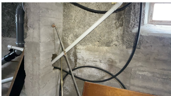
Ufagmessig utførelse og manglende klamring.
