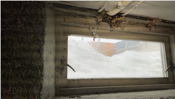
Sprukket kjellervindu registrert.
