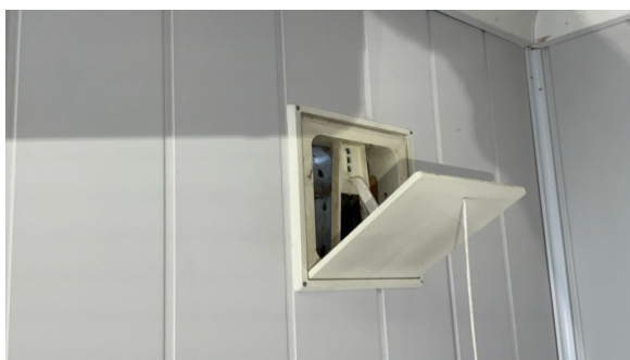
Utett veggjennomføring ventil 1. etasje.
