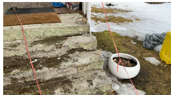
Manglende rekkverk i betongtrapp.
