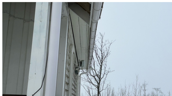
Noe skjevheter i takkonstruksjonen registrert.
