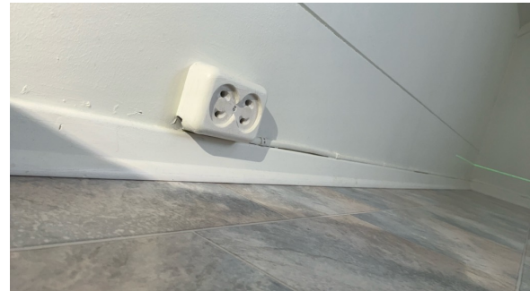
Deler av anlegget er eldre, utett stikkontakt.
