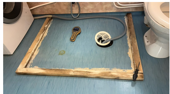
Treterskel hindrer eventuell lekkasjevann i å nå sluk.
