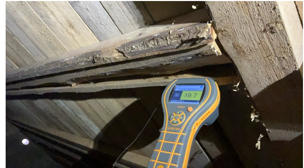
Enkle fuktmålinger viste skadelige verdier. Dette tilsier at konstruksjonen er utsatt for fukt og øker risikoen for sopp og råte.
