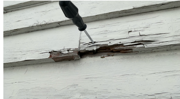
Råteskadet kledning flere steder.
