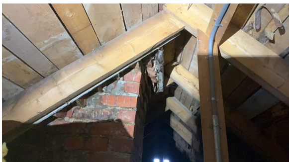
Møneloft er inspisert via inspeksjonsluke fra gardintrapp. Det var ikke gangbart gulv eller annen adkomst. Fuktmerker og misfarging blant annet rundt pipe. Fuktmåling i disse områdene er ikke foretatt.
