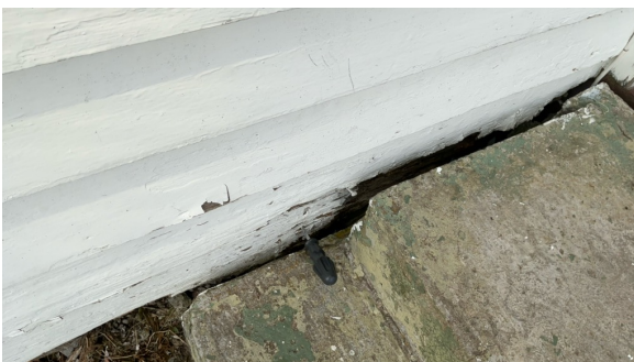
Råteskader på vegg bak betongtrapp. Indikasjoner på bakenforliggende råteskader i veggkonstruksjonen. Dette anbefales undersøkt ytterligere. Forholdet gis tilstandsgrad 3.
