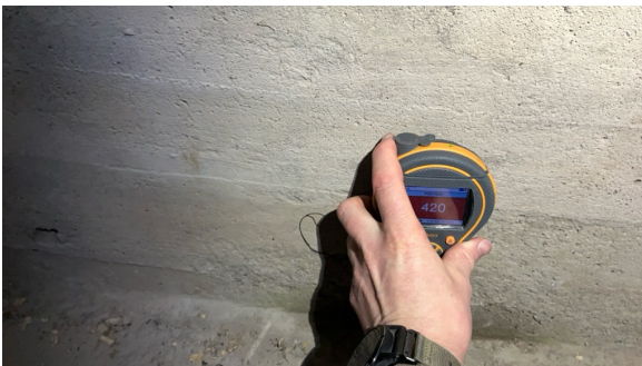
Fuktsøk viste forhøyde verdier.
