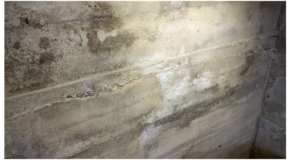
Saltutslag på vegger.
