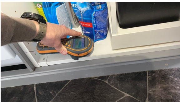
Noe svelling under kjøkkenkum. Fuktsøk viste normale verdier.
