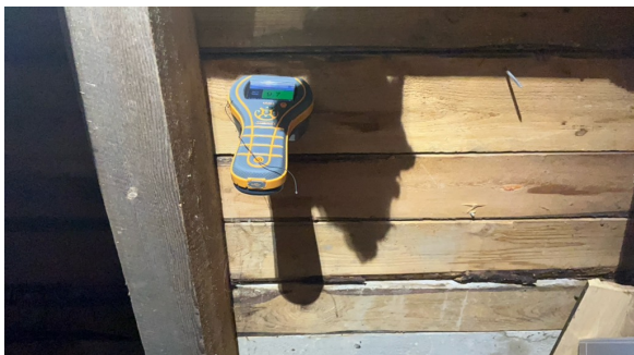
Fuktskjolder og fuktmerker flere steder. Fuktmålinger viste tørre verdier.
