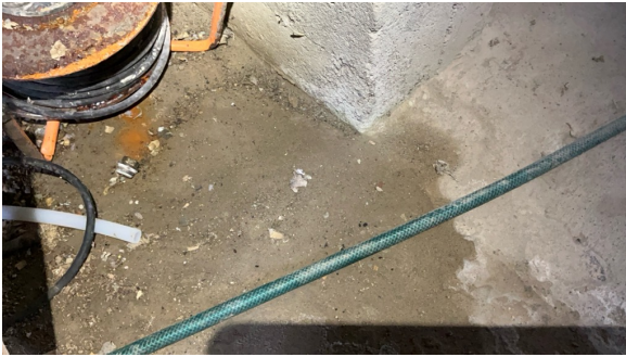
Synlig fukt enkelte steder.
