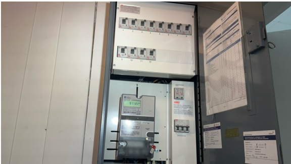
Sikringskap plassert i loftsetasje.
