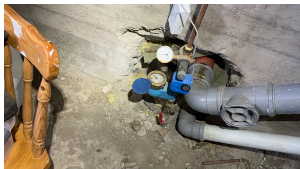
Stoppekran og vannmåler i kjeller.
