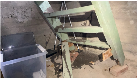
Defekt og råteskadet kjellertrapp. Forholdet gis tilstandsgrad 3.
