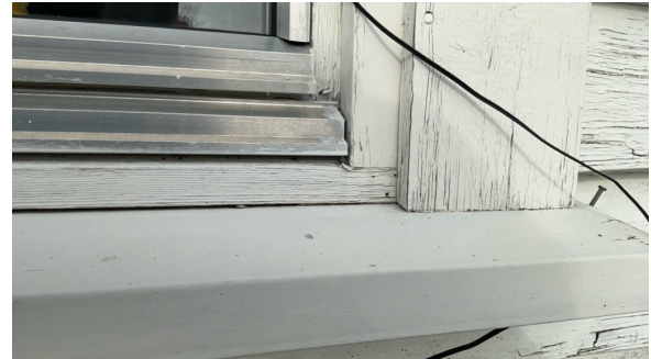
Eldre vinduer bærer preg av slitasje. Flere vinduer i boligen er skiftet og har ikke denne slitasjegraden som avbildet.
