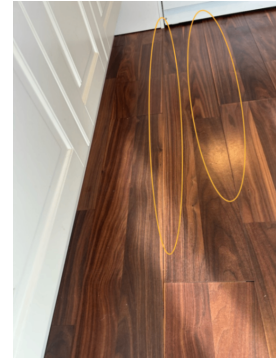
Langsgående skjøter har sklidd fra hverandre.
