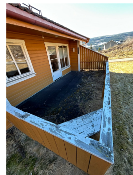
Terrassearealet. Rekkverk er slitt.
