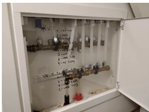
Vannskap for rør i rør system.
