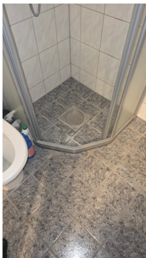
Tett list rundt sluk i forbindelse med dusj.
