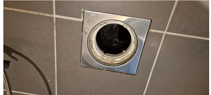
Sluk under dusjkabinett
