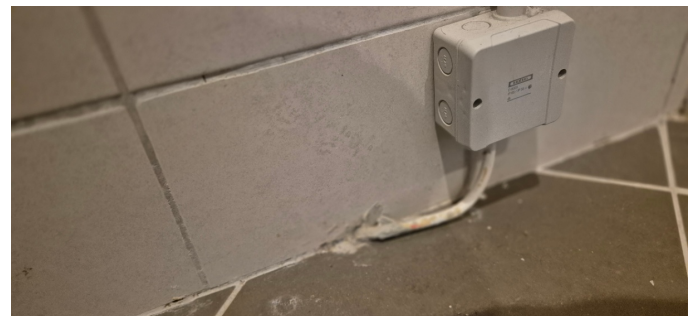
Kabel gjennom gulv/vegg bak dusjkabinett
