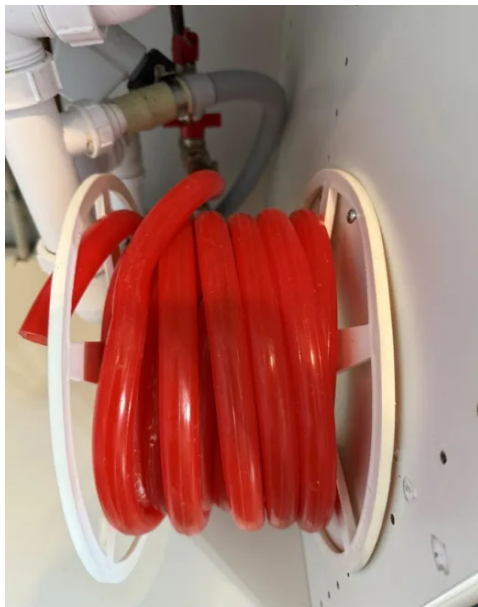
Brannslange i kjøkkenbenk
