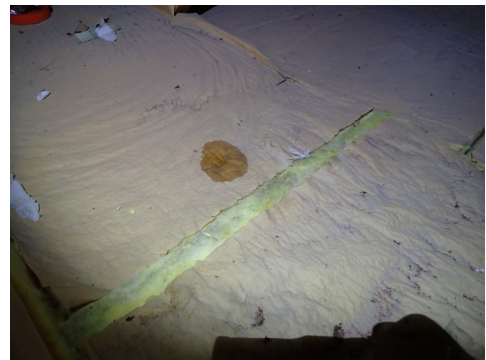
Fuktmerke rett under luftelyr
