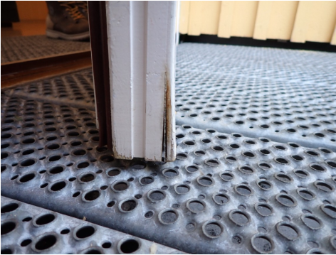
Begynnende fuktskade på inngangsdør
