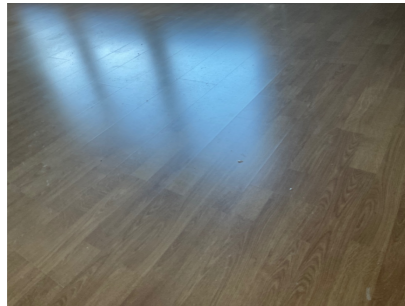
Eldre laminat med noe tugging.
