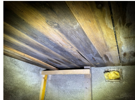
Fuktmerker i trepanel på undersiden av gulv mot kjeller
