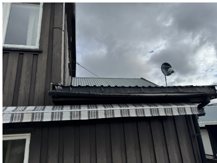
Skader i takrenner og rust i beslag
