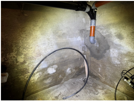
Fuktskjolder saltutslag på overflater av grunnmur
