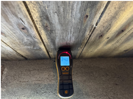
Høy fuktighet på undersiden av gulvkonstruksjon mot kjeller som skyldes høy fuktighet i kjeller.
