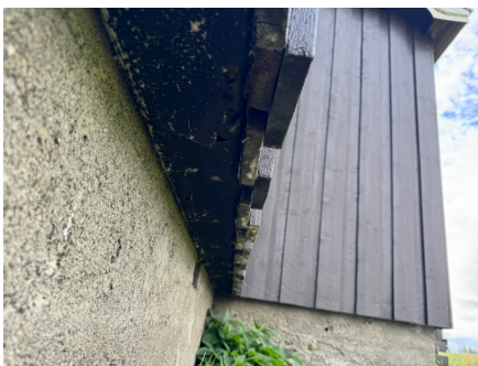
Ikke lufting under panel
