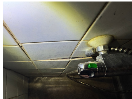
Løse fliser i dusjsone
