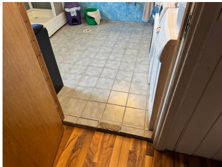
Manglende fliser ved inngang til badet
