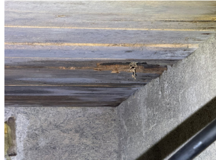
Lokal råte observert fra kjeller
