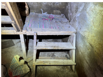
Råte i nedre del av trapp
