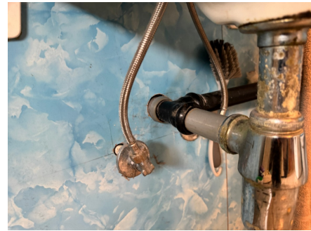
Utett rundt gjennomføringer under vask
