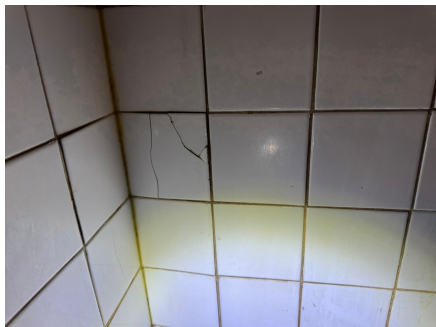
Løse fliser i dusjsone
