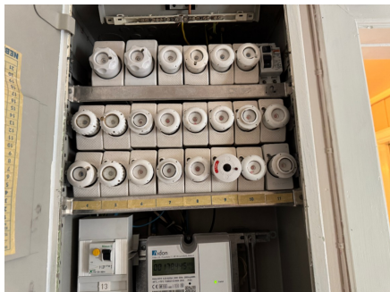
Sikringer i sikringskapå
