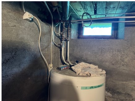
Bereder tilkoblet med stikkontakt i kjeller
