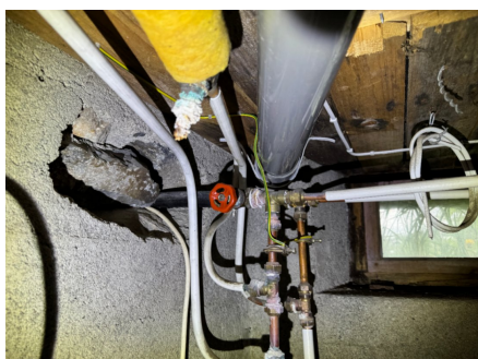
Irr på rørkoblinger i kjeller
