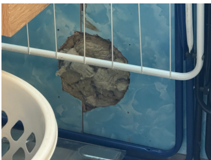
Hull i vegg etter tidligere montert tørketrommel
