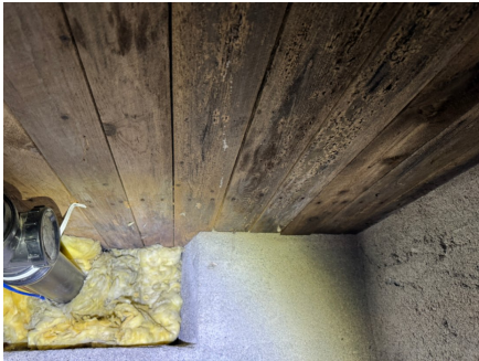
Fukt i treverk på undersiden av gulvkonstruksjon mot kjeller
