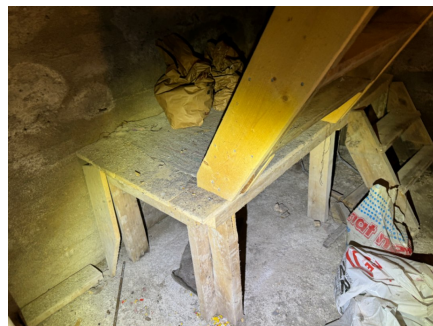
Ikke rekkverk i trappen
