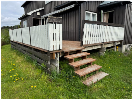
Trapp uten rekkverk
