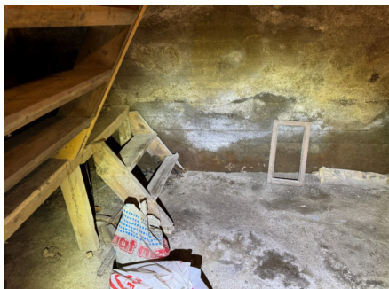
Råte i nedre del av trapp
