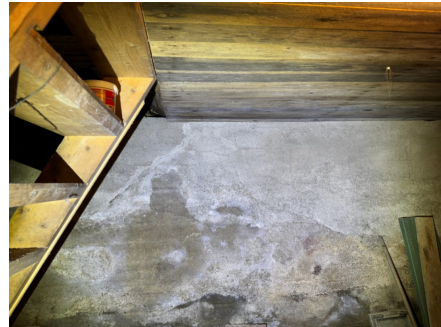
Sprekker i grunnmur
