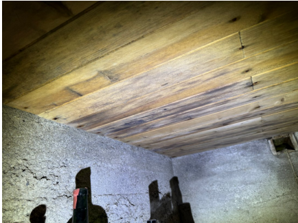
Fuktmerker på undersiden av gulvkonstruksjon mot kjeller
