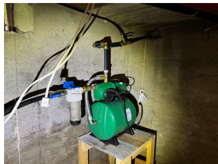
Stoppekran i kjeller
