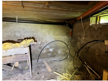
Fukt i grunnmur og kjellergulv
