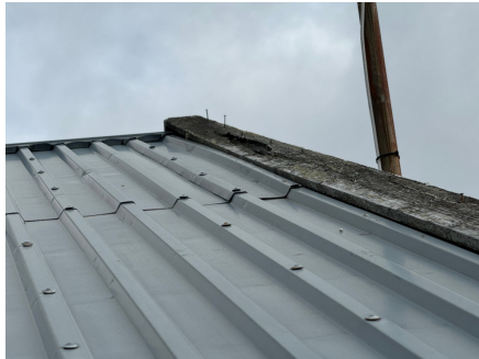
Råteskade i dekkbord
