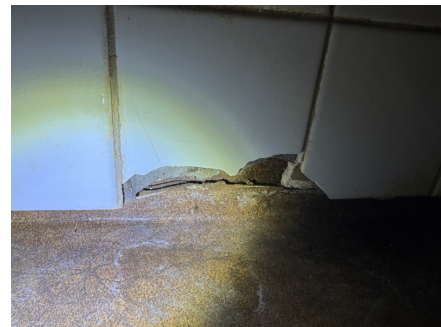
Løse fliser/skader i dusjsone
