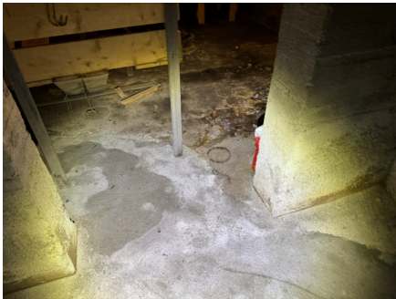
Saltutslag og fukt i kjellergulv
