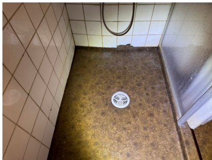
Løse fliser i dusjsone
