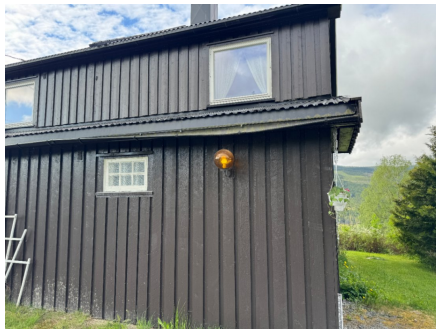
Deformasjoner i takrenner
