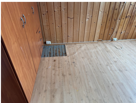
Slitasje/skader i overflater
