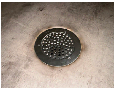
Noe misfarging i belegg rundt sluk.
