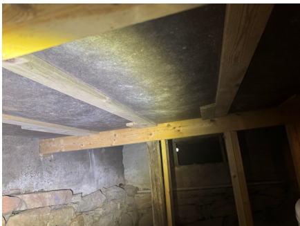
Sopp på undersiden av bjelkelag
