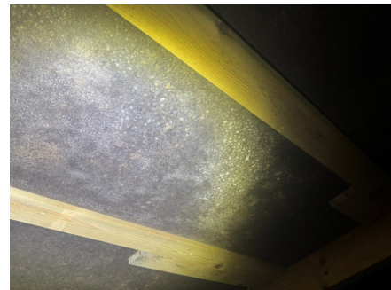
Sopp på undersiden av gulvkonstruksjon mot jordkjeller/krypkjeller
