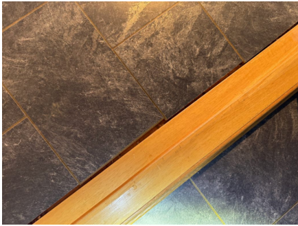
Glippe mellom terskel og laminatgulv
