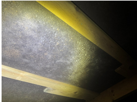
Sopp på undersiden av gulv mot jordkjeller/krypkjeller
