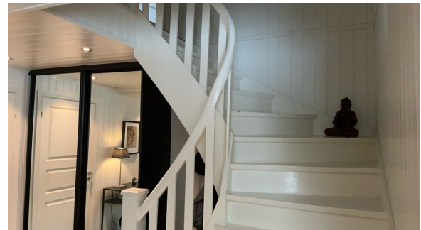
Ikke montert håndlist på vegg i trappen
