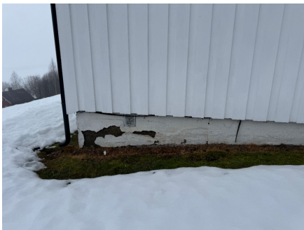
Avflassing og sprekk i grunnmur
