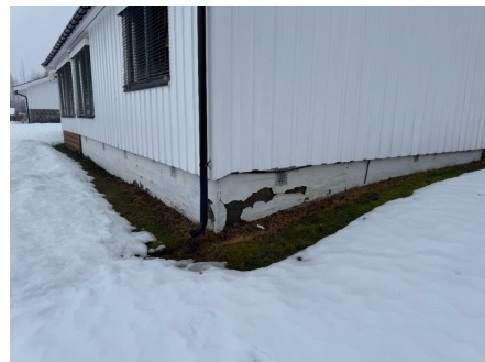
Avflassing i grunnmurens overflater
