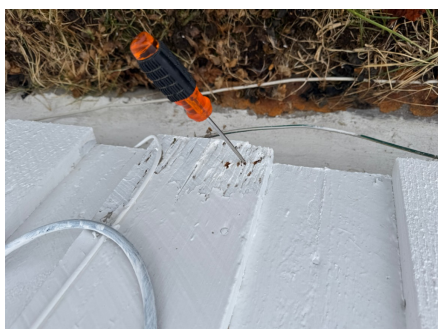
Ett panelbord med råteskader nederst
