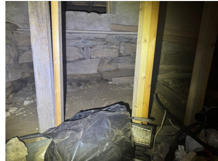
Ikke plast på grunn i jordkjeller/krypkjeller
