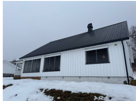
Ikke montert snøfangere
