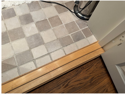
Sprekker i fuger mellom fliser
