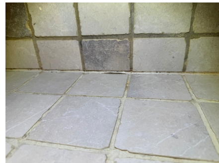
Sprekker i silikonfuge
