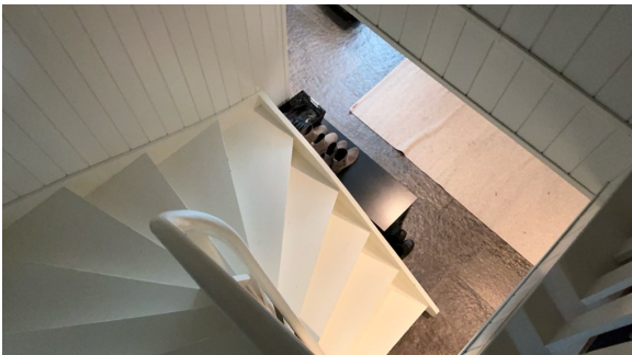
Ikke rekkverk i nedre del av trapp
