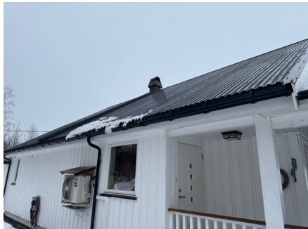
Ikke montert snøfangere
