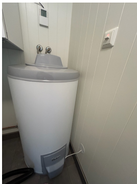
Varmtvannsbereder på teknisk rom.
