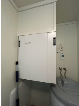
Ventilasjonsaggregat plassert i teknisk rom.
