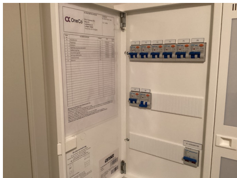
Bilde av sikringskap
