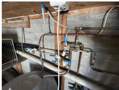
Vannrør i kryprom
