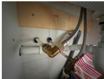
Vannrør på bad uten veggbocks
