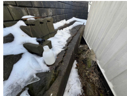
Støttmur med skader
