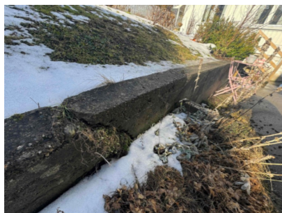
Støttmur med skader
