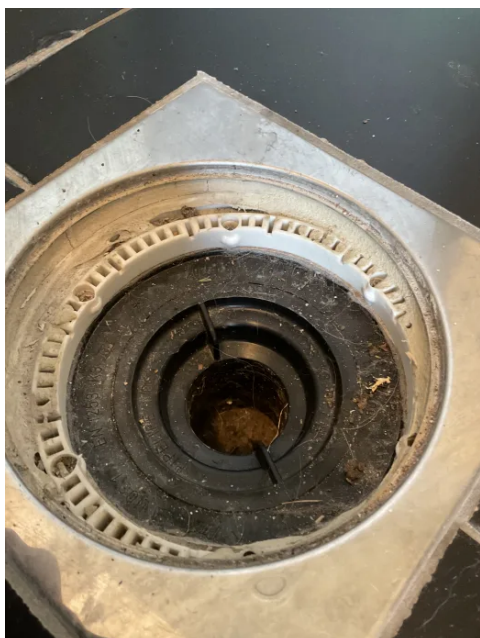
Slukmannsjett synlig ført under klemring
