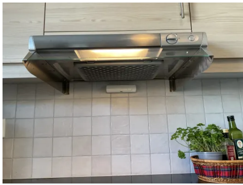
Komfyrvakt er montert over koketopp
