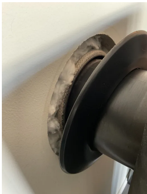
Røykgassgjennomføring med tilfredsstillende tetting med snor
