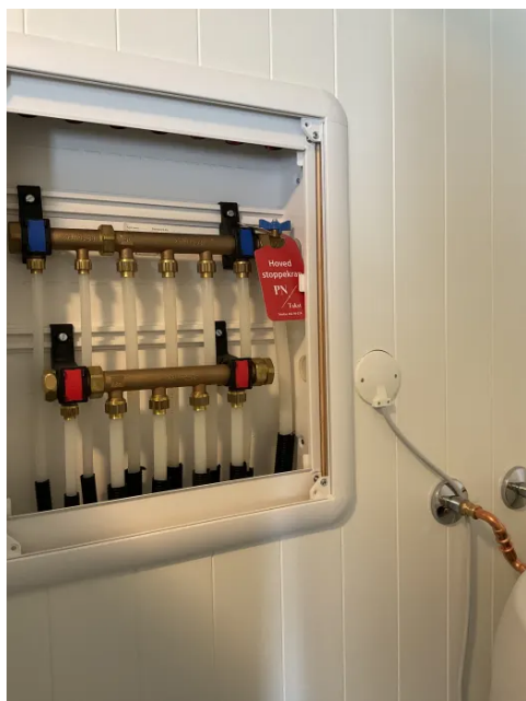
Hovedstoppekran med synlig merking
