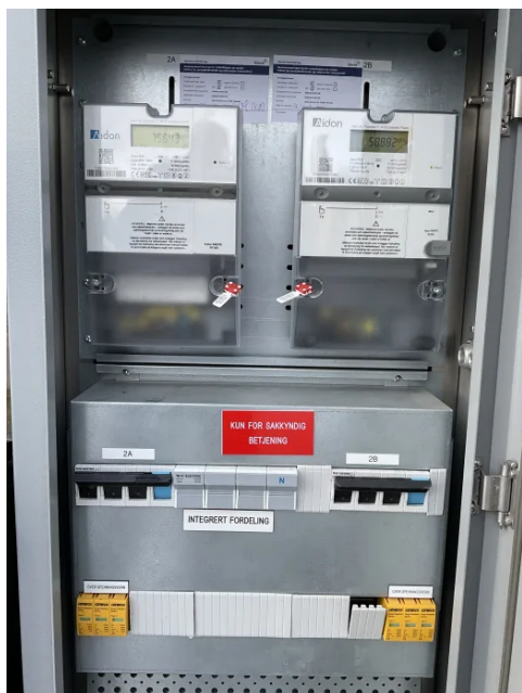
Digital måleravleser montert i utvendig skap
