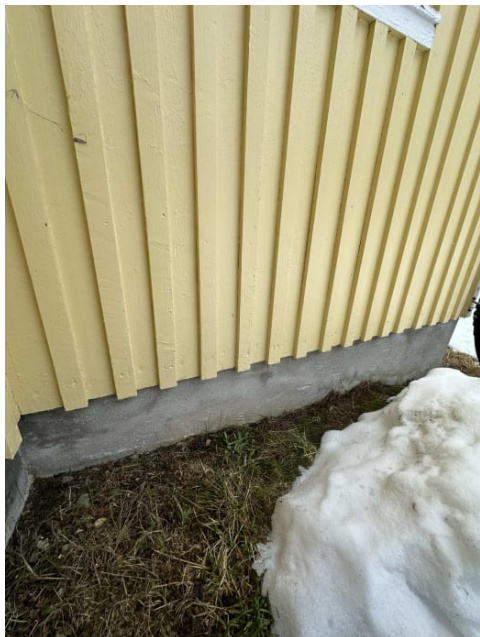
Ingen synlig fuktsikring ved grunnmur.
