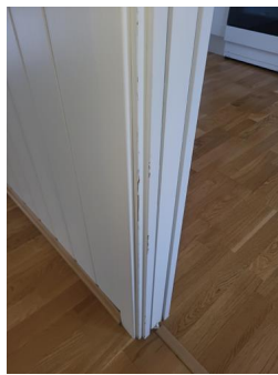
Innerdører - Enkelte slitasje merker på karmen/listverk
