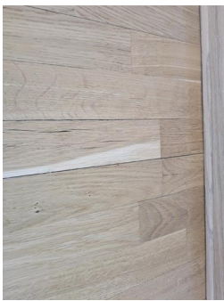
Overflate gulv - Slitasje på parkett gulv i stue, i nærheten av balkongdør.
