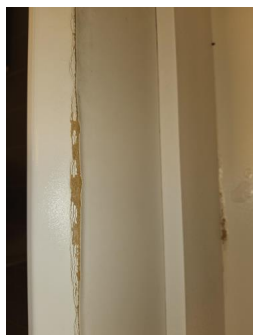
Sanitærutstyr og innredning - Svelling på fronter
