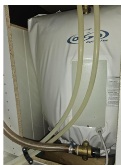
Varmtvannsbereder - VVB i kjøkkenbenk
