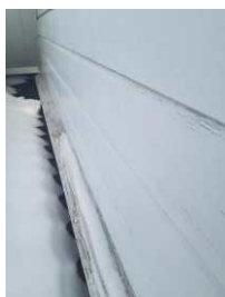
Ytterkledning (fasademateriale, vannbord, utvendig listverk, o.l.) - Malingslitasje.
