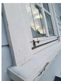
Vinduer og omramming - Malingslitasje.
