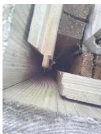
Gnagersikring - Manglende sikring bak hjørnebord.
