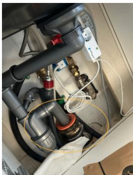
Overgang fra nyere avløp til gamle støpejernsrør.
