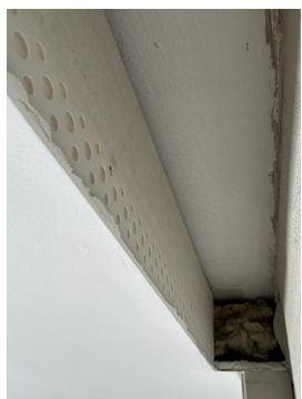
Mangelfullt arbeid rundt utkraging ved pipe/brannmur.
