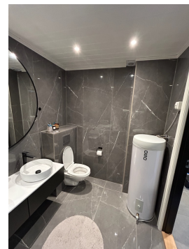
Plassering av varmtvannsbereder på bad.
