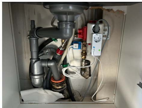
Vannledninger, samt hovedstoppekran, plassert i skap under kjøkkenvask.
