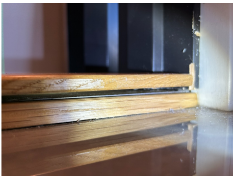
Ved løfting av terskel kan man se toppen av membranen, denne er målt til ca. 15 mm over flis.
