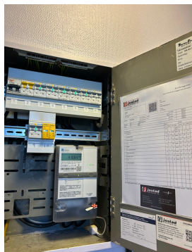
Sikringskap med automatsikringer.
