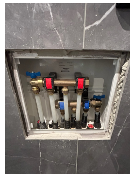
Vannfordelerskap plassert på bad.
