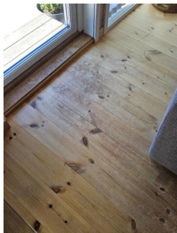
Overflate gulv - Slitasje på gulvflater.
