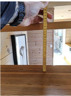
Rekkverk og håndløper - Åpninger i trapp.
