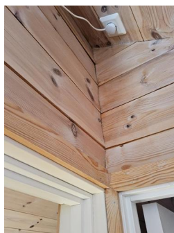
Overflate vegg - Skjevheter/vridning i panelbord.
