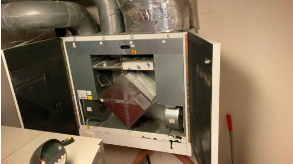
Ventilasjonsaggregat er montert i teknisk rom i underetasje.
