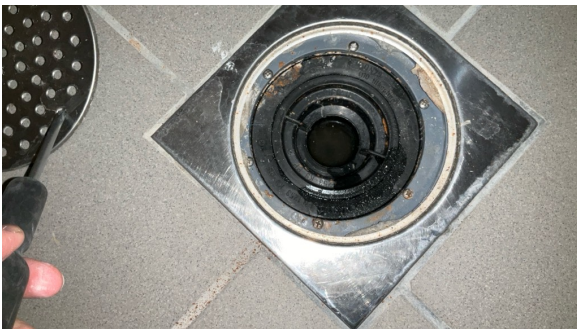
Ingen synlig membran i sluk.
