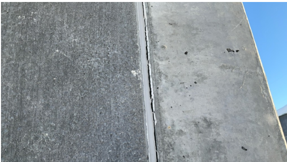
Det er observert oppsprekking i fuger mellom elementer.
