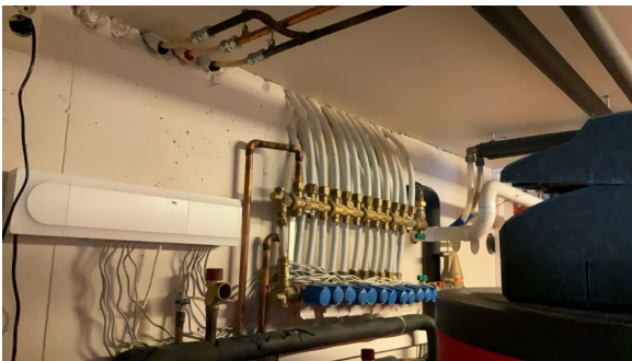
Vannrør for vannbåren varme og styringer.
