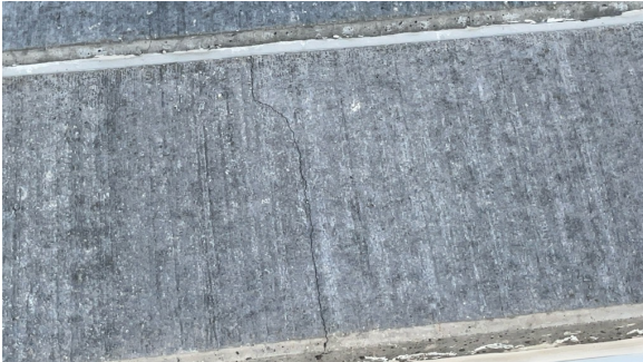
Sprekk i fasadelement over vindu/før ved terrasse. Opplyst fra revkivert at sprekk kom i forbindelse med heising av betongelementer og at den ikke har utviklet seg.
