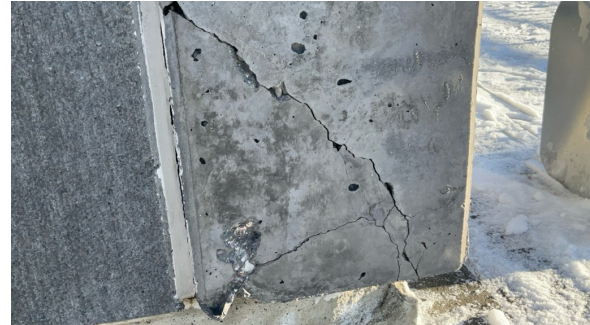
Observert noe sprekkdannelse/ skader i ende på elementer.
