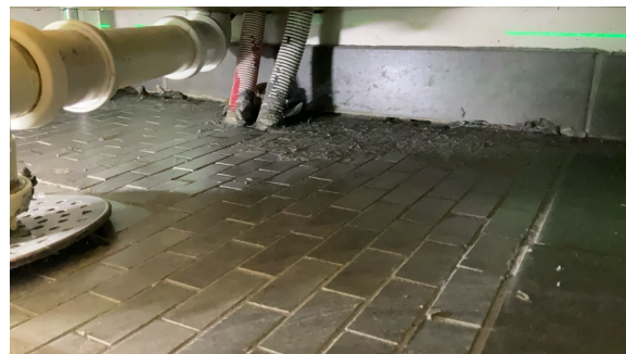
Rørgjennomføringer i tettesjikt. Det er ingen synlig mansjett eller tetting rundt rørgjennomføringen, og det er ikke fremlagt dokumentasjon som viser hvordan løsningen er utført.
