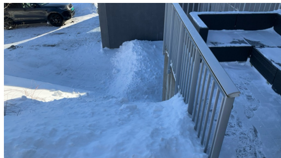
Ved inngangsparti: Manglende rekkverk.
