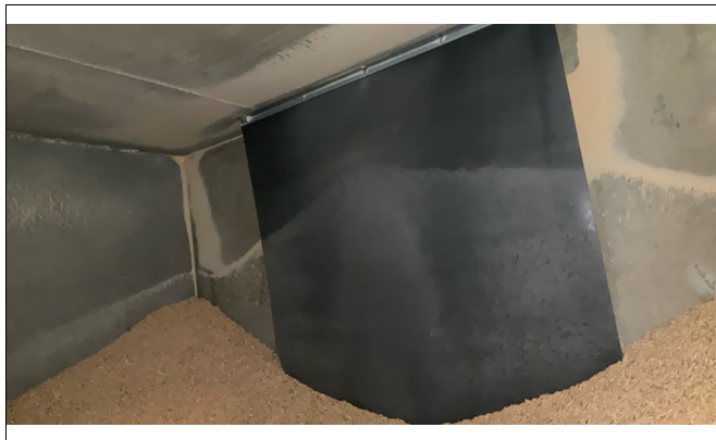
Bilde fra pelles silo i underetasje. Adkomst via Vindu i teknisk rom.
