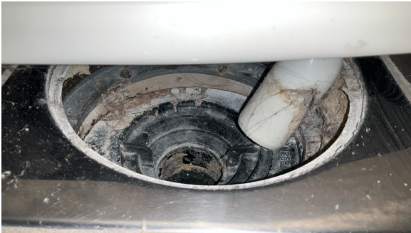
Sluk ved badekar: Synlig membran/ slukmansjett i sluket. Ukjent type membran/tettesjikt.
