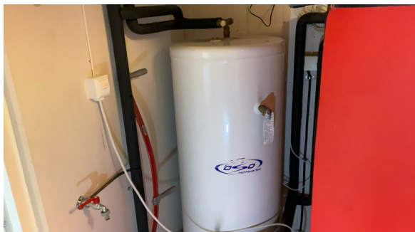
Varmtvannsbereder på ca. 300L er plassert i teknisk rom i underetasjen.
