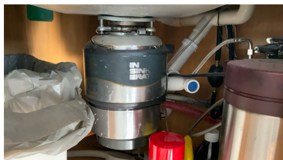
Det er montert matkvern i kjøkkenbenk. Kommunenes praksis kan variere, og det er noe usikkerhet rundt om slike installasjoner tillates av Gjøvik kommune. Det anbefales at kjøper foretar ytterligere undersøkelser med kommunen for å avklare forholdet.
