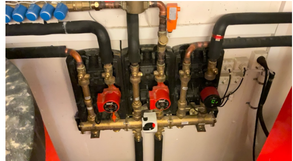
Fordeling mellom bedrer og el kjel/ pellets-fyr.
