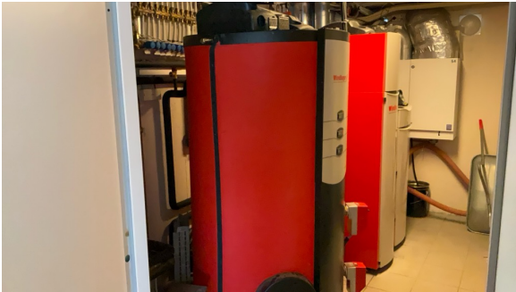
Teknisk rom i underetasje.
