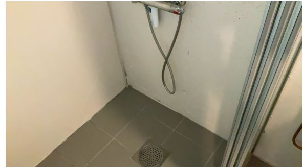
Det dusjes direkte på betongoverflater.
