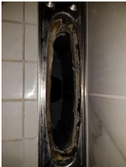
Vanntett sjikt / membran i gulv og vegger - Sluk bad 1.etasje
