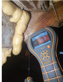
Synlige overflater (taktro, vegger, gulv, o.l) - Fuktmåling på fuktmerke ved pipe.
