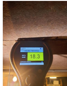
Stikktaking i treverk, fukt og fuktmålinger - Fuktmåling i etasjeskille/bjelkelag krypkjeller.
