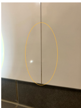
Plateskjøt glipper, og det er tegn til at det mangler fugemasse.
