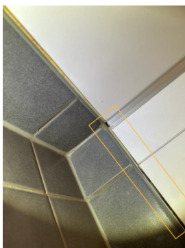
Mangelfull fuging under plater mot bunnskinne.
