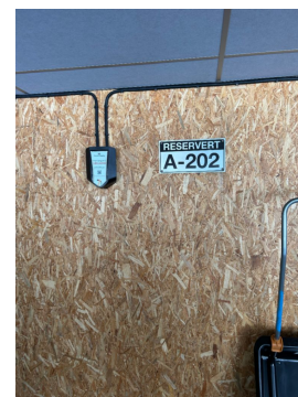
Parkering i carport, tilrettelagt for elbillader.
