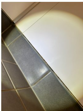
Mangelfull fuging under plater mot bunnskinne.
