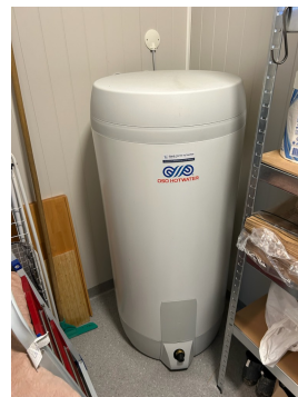
Varmtvannsbereder plassert på teknisk rom.
