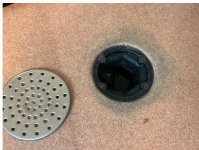
Sluk i dusjsone.
