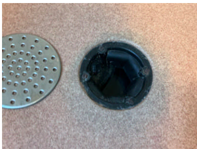
Sluk utenfor dusjsone.
