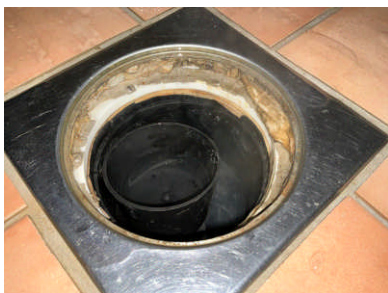
Sluk i dusjsone.
