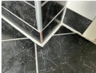
Det er ikke alle fliser som er fuget eller tilpasset.
