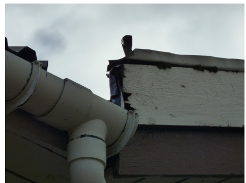
Manglende beslag, begynnende råte
