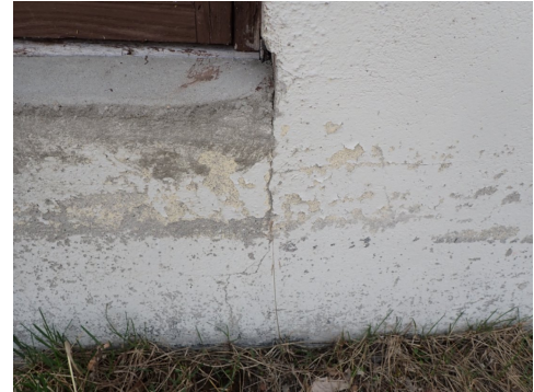
Eksempel på riss
