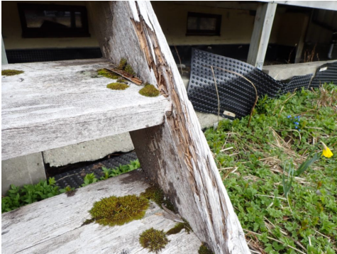
Råteskader i vanger og trinn
