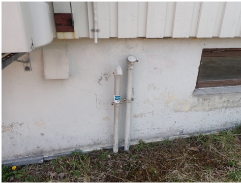
Påfylling- og lufterør mot nordøst
