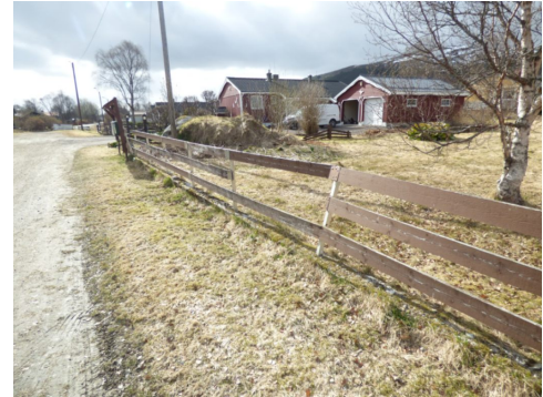
Skader på gjerde
