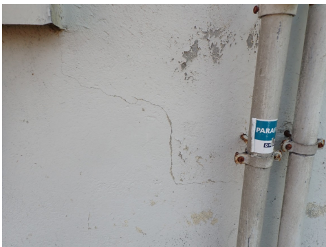
Eksempel på riss
