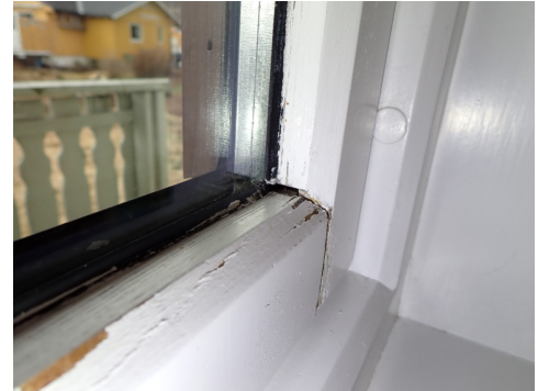
Nedre del av vindu har seget
