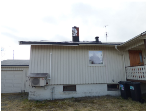
Takrenne er revet ned, trolig pga snø/is
