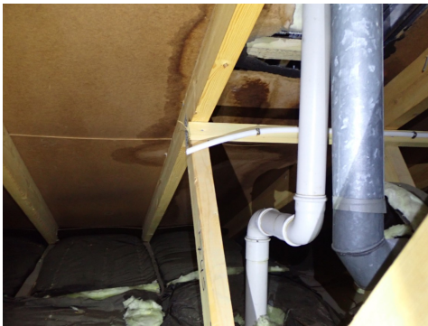
Fuktskjolder ved luftelyr
