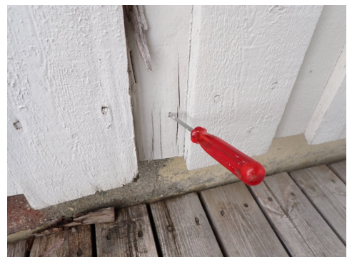
Råteskader på mindre del av kledning
