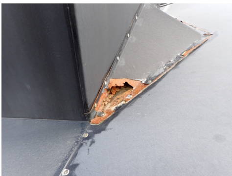
Rust i del av pipebeslag
