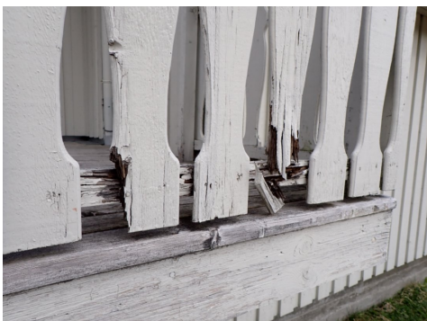
Eksempel på råteskade
