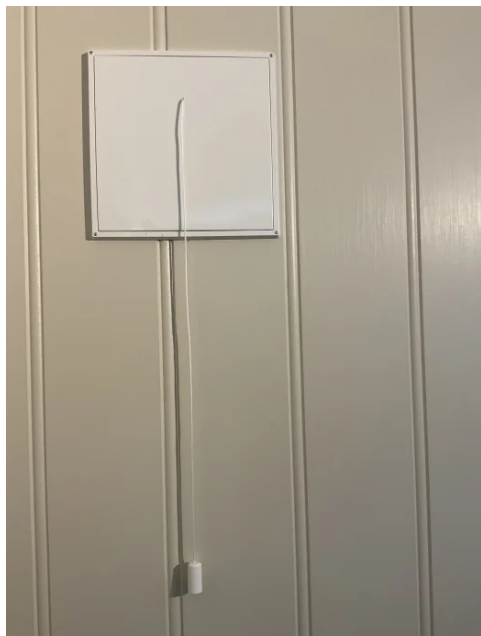
Bolig med naturlig ventilasjon
