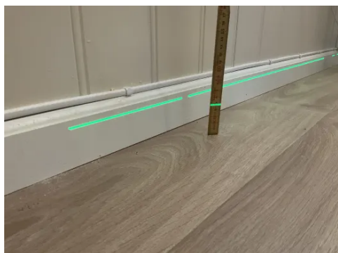
Målt avvik på 8 mm stue 1.etasje
