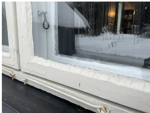
Utvendig ramtre og kitting med noe malingoppsprekking og lokal slitasje
