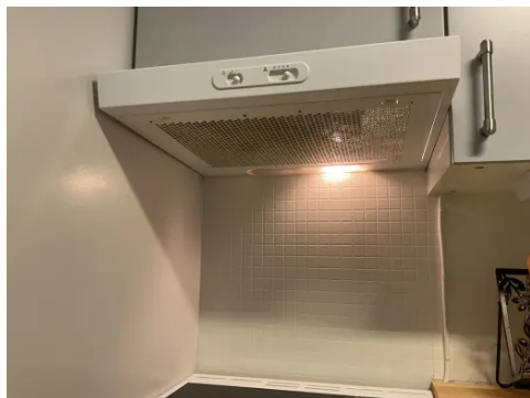
Ventilator over koketopp
