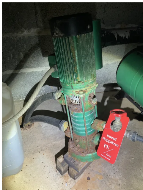
Hovedstoppekrane med synlig merking
