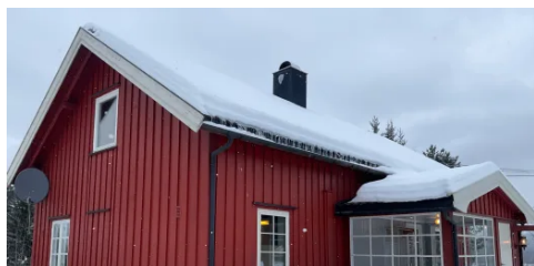
Ikke kontrollert grunnet snøforhold
