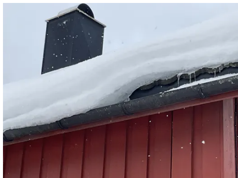
Påvist isdannelse ved takfot og mot renner
