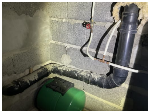
Synlige innvendige avløpsrør med PVC-plast
