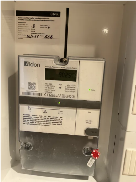
Digital måleravleser montert i skap
