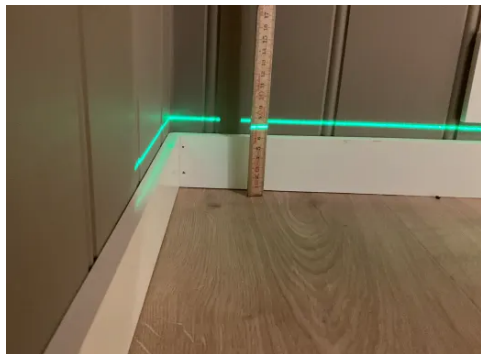
Målt avvik på 15 mm soverom 2.etasje
