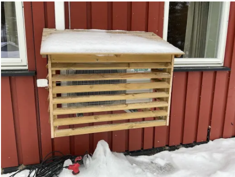
Luft/luft varmepumpe påvist fra 2022
