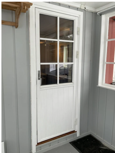
Malt terrassedør med isolerglass påvist fra 2005
