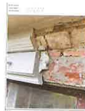
Store skader ved fjerde etasje
