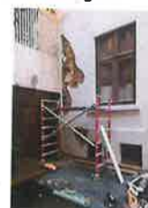
Manglende takrenne nabogårdens side av bygget over skadestedet
