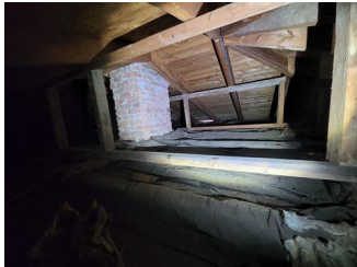
Helhetsvurdering - Loft over tilbygg.
