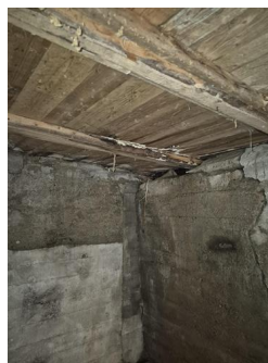
Overflate gulv - Skader i gulvkonstruksjon under tilbygget gang mot sydøst.
