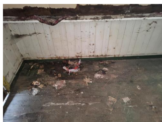
Overflate gulv - Eksempel på skader i gulv i gang mot sydøst.
