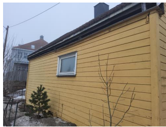
Takrenner og utvendige nedløp - Område med manglende takrenner.
