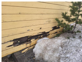
Ytterkledning (fasademateriale, vannbord, utvendig listverk, o.l.) - Eksempel på råteskader.
