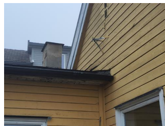
Ytterkledning (fasademateriale, vannbord, utvendig listverk, o.l.) - Eksempel på råteskader.
