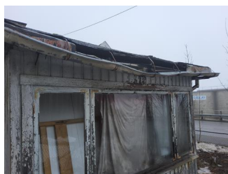
Takrenner og utvendige nedløp - Takrenner med store deformasjoner.
