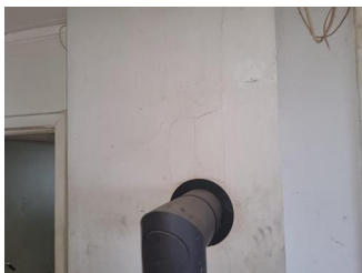
Skorsteiner inne i boligen - Riss i skorstein i stue.
