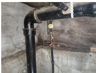
Innvendig stoppekran - Hovedstoppekran og vannmåler.
