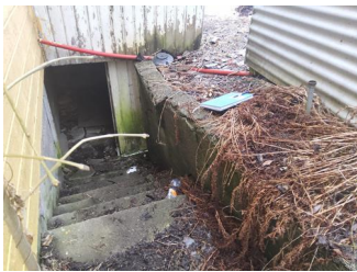
Tilstand - Eksempel på sprekker i støttemur mot uthus.
