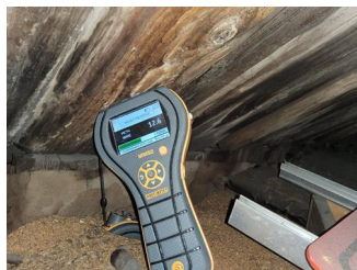
Synlige overflater (taktro, vegger, gulv, o.l) - Fuktmåling i undertak.
