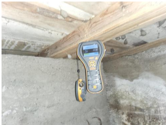
Overflate himling - Fuktmåling i himling i kjeller.
