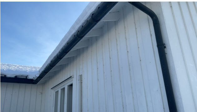
Ingen luftespalte under takutstikk.
