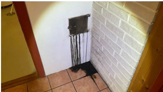
Sotvann under feieluke.
