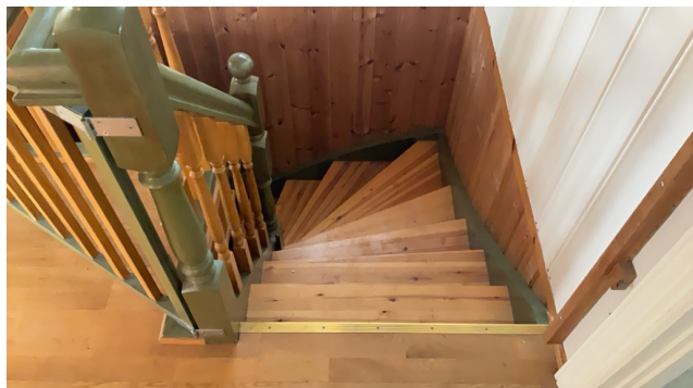
Mangler håndlist på vegg.
