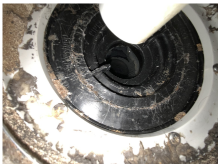
Sluk under dusjkabinett.
