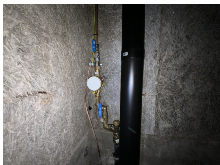
Stoppekran ved vanninntak i kjeller fra 2015.
