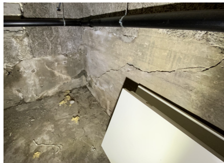
Eksempel på sprekkdannelse i grunnmur.
