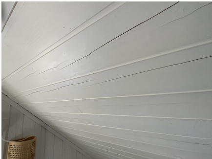
Eksempel på sprekke-dannelser i trepanel. Bildet fra himling i loftetasje.
