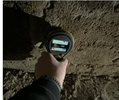
Forhøyet fuktinnhold på vegger mot terreng. Påvist ved fuktsøk på overflater.
