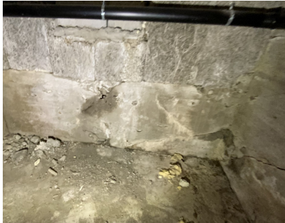
Enkelte synlige fuktmerker på vegger mot terreng i kjeller.
