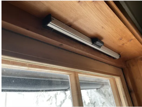
Enkelte luftespalter i øvre del av vinduer
