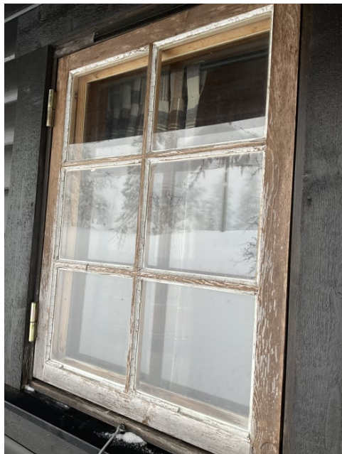
Utvendig ramtre og kitting med slitasje
