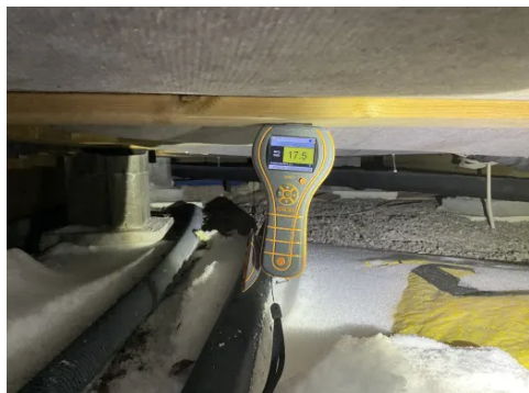
Målt 17,5 i fuktprosent i krypkjeller
