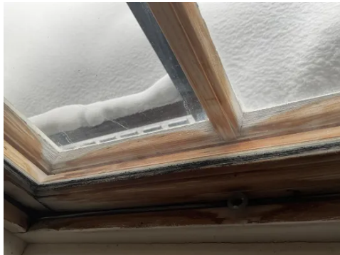
Innvendig ramtre med svertesopp, avflassing og fuktskjolder
