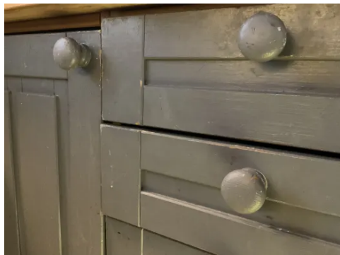
Innredning med noe malingavflassing og lokal slitasje
