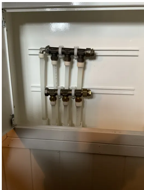
Fordelerskap med avrenning for evt lekkasjevann til gulv med sluk
