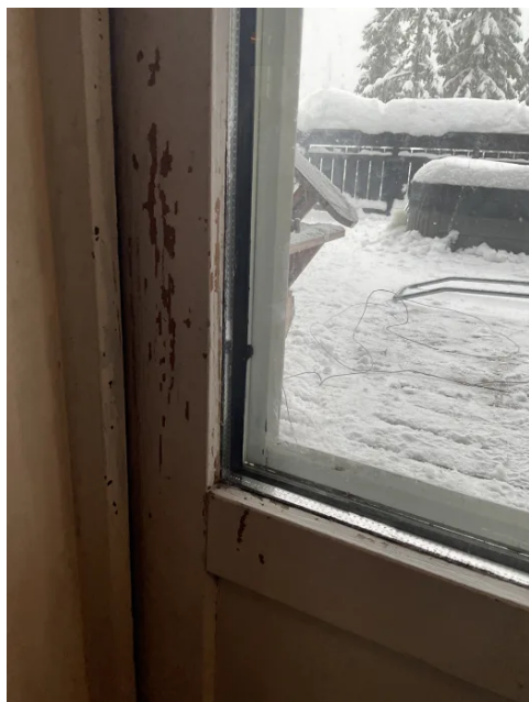
Installasjoner med malingavflassing og lokale slitasjeskader innvendig
