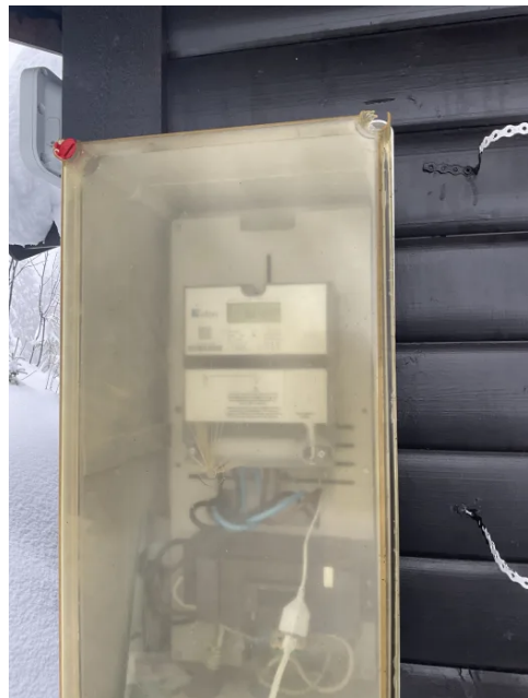
Digital måleravleser plassert i utvendig skap
