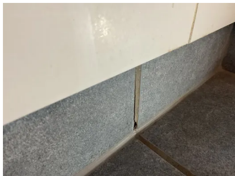
Fastfuge i overgang gulv og veggflis med noe oppsprekking og lokal slitasje
