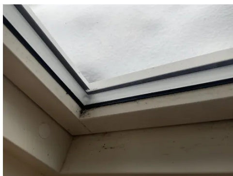
Innvendig ramtre med svertesopp
