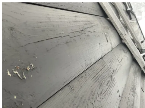
Lokal slitasje på utsatte plasser
