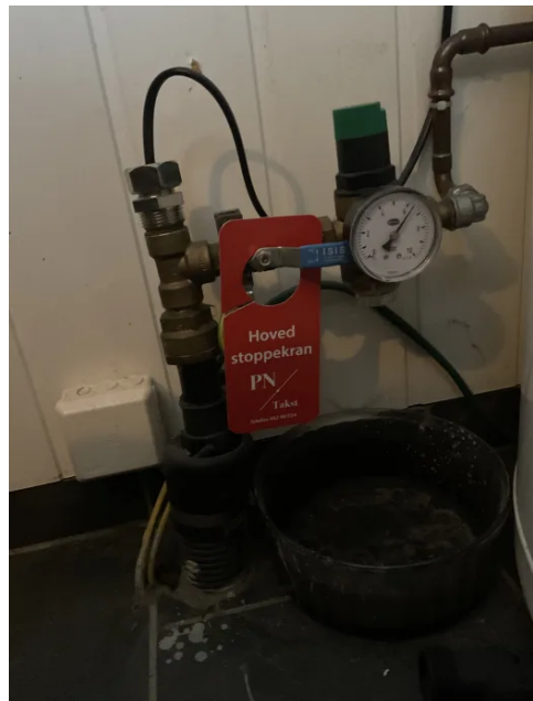
Hovedstoppekrane med synlig merking
