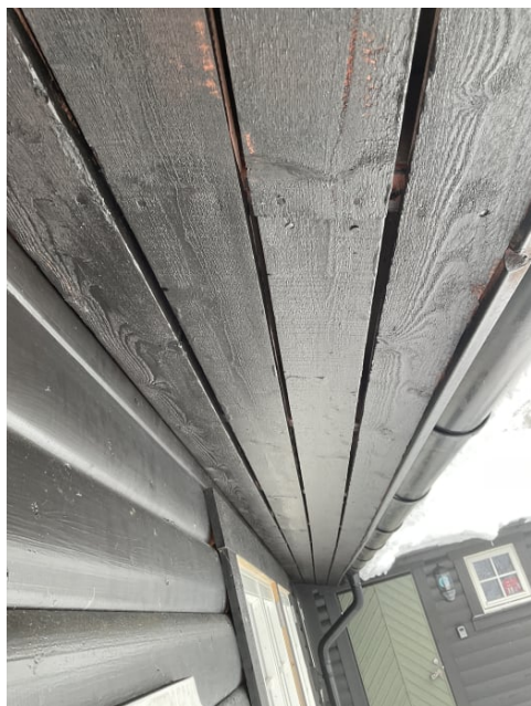
Luftespalter ved raft
