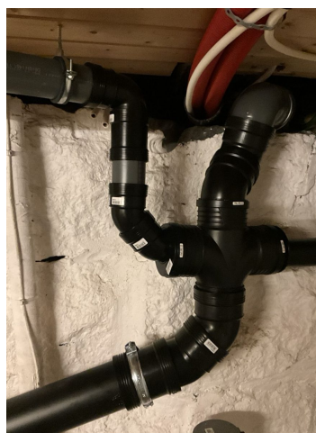
Foto 15: Foto viser avløpsrør av plast i kjeller.
