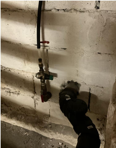
Foto 14: Foto viser stoppekran i kjeller.
