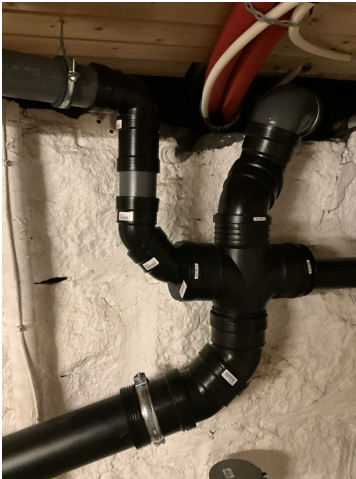
Foto 15: Foto viser avløpsrør av plast i kjeller.
