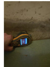
Overflate vegg - Fuktsøk veggoverflate med misfarging bod ved kjøkken.
